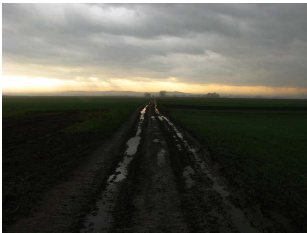
Fot. nr 22. Rozmoknięta droga transportu rolnego nr 167 w Zielenicach.
